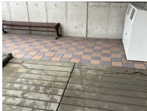
↑体育館スロープの段差
